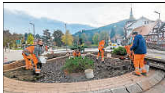
Mitarbeiter des Herrenalber Bauhofes bei den Arbeiten zur Begrünung der Verkehrinsel am Rathausplatz.
