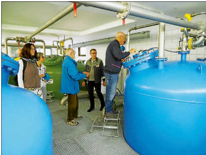
Im Wasserwerk Dobeltal wird das Quellwasser aufbereitet.
